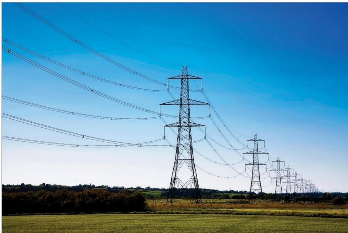
Рисунок 1. Воздушные линии электропередач.
